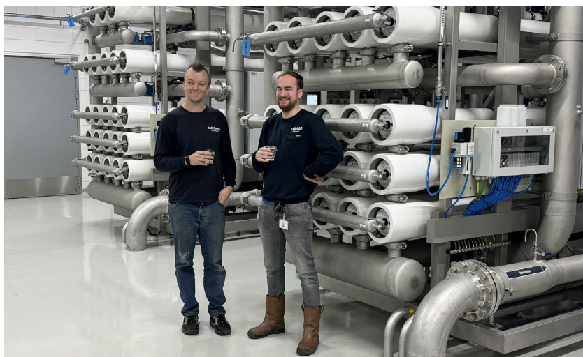
In november nam Oasen zuiveringsstation Kamerik in gebruik.
